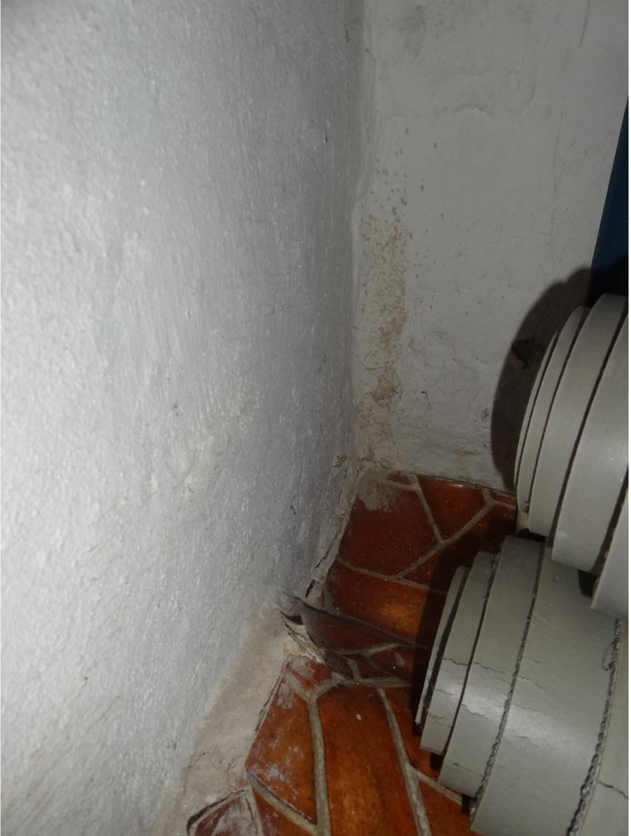
Opfugtning i murværk.
